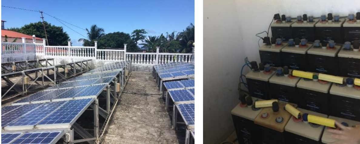
Ilustración 9: Planta FV de GETESA con generador solar (izquierda) y acumulación (derecha)
