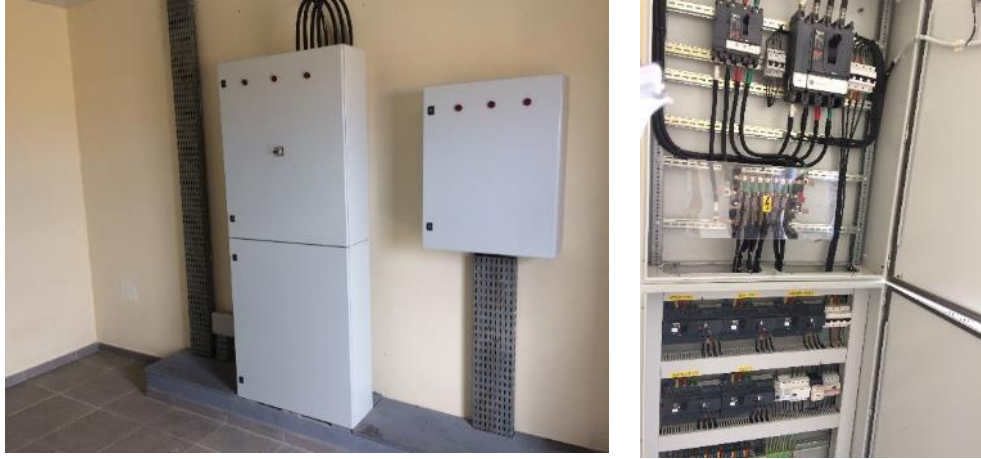
Ilustración 23: Sala de distribución eléctrica del nuevo hospital de San Antonio de Palé (fuente: TTA)
